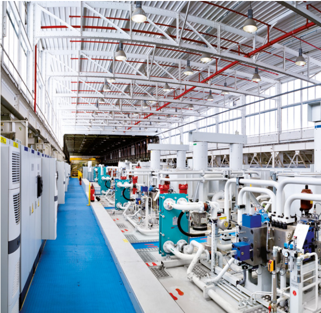
Gute Zugänglichkeit für Wartungsarbeiten.
