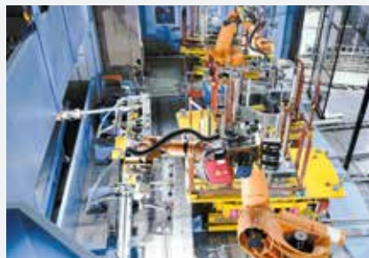
Abstapelanlage mit Roboterautomation.
